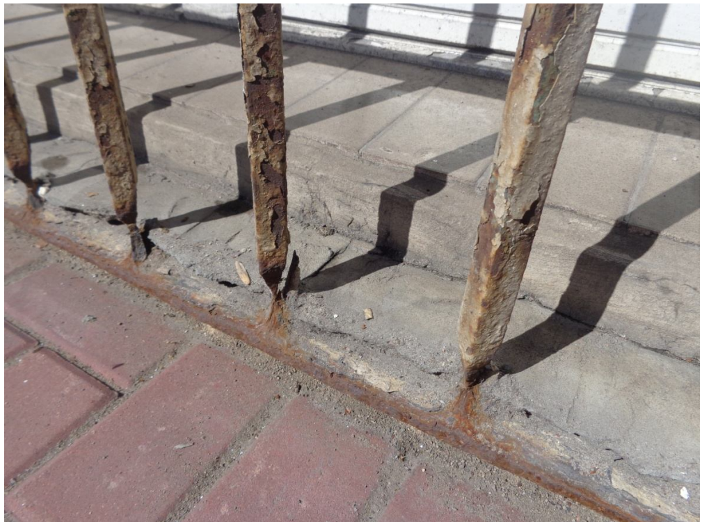
Uszkodzone korozją kraty zewnętrzne przy oknach piwnicy od ul. Nowogrodzkiej
