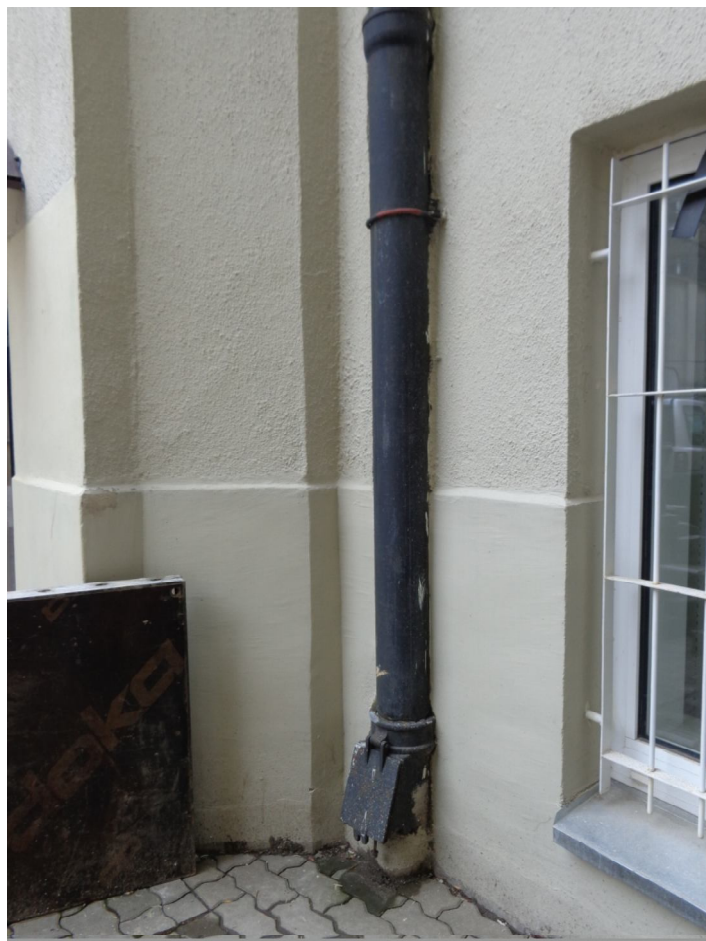
Wpusty kanalizacji deszczowej – przewiduje się czyszczenie i malowanie
