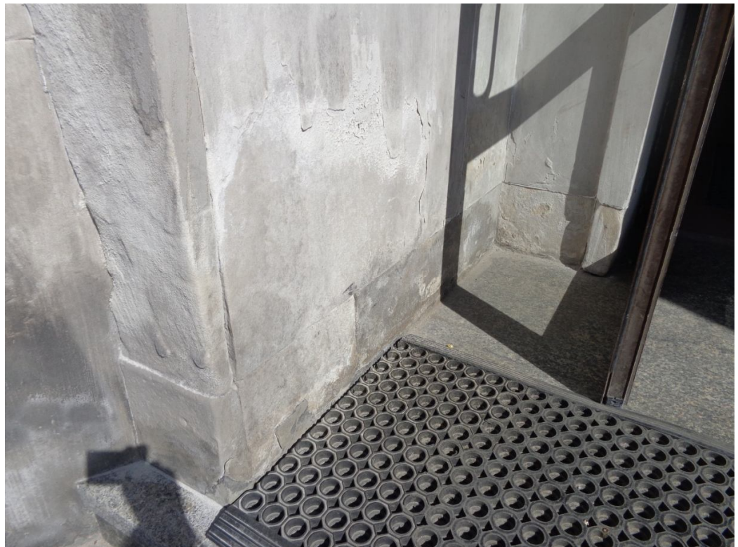
Portal od ul. Lindleya - wykwity solne na okładzinie z piaskowca
