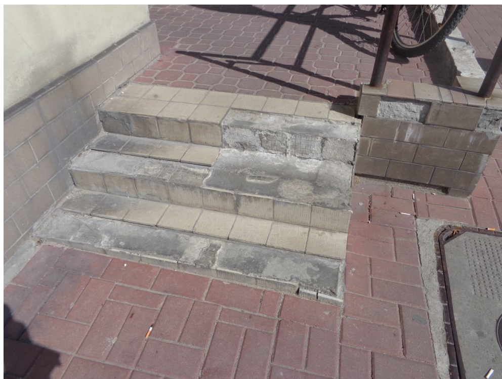
Odspojone okładziny schodów zewnętrznych i pochylni dla osób niepełnosprawnych od ul. Nowogrodzkiej
