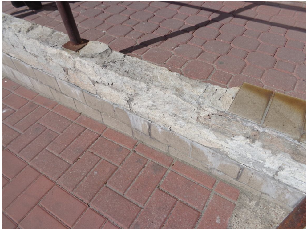
Odspojone okładziny pochylni dla osób niepełnosprawnych od ul. Nowogrodzkiej
