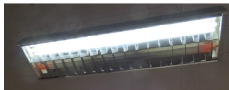
Oprawa świetlówkowa 2x36W
